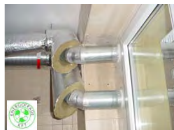
Ásványgyapot szigetelés a légcsatornákon
