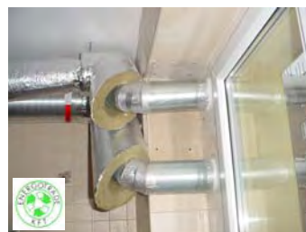
Ásványgyapot szigetelés a légcsatornákon
