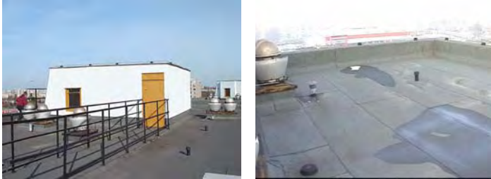
A lapos tető állapota a felújítás előtt
