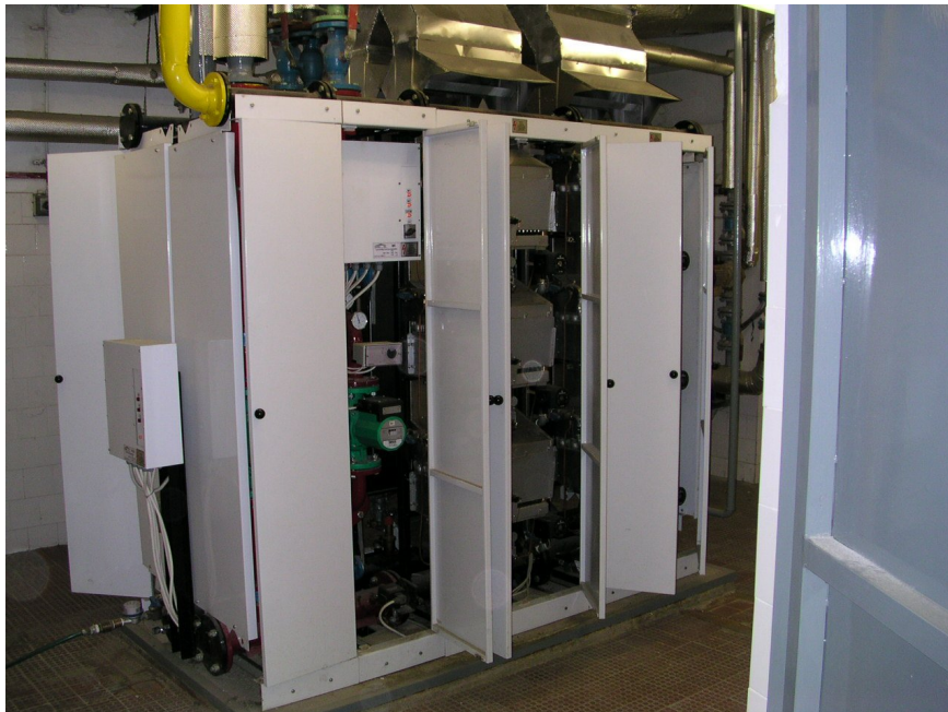
40. ábra FÉG F-105-ös kazántelep
